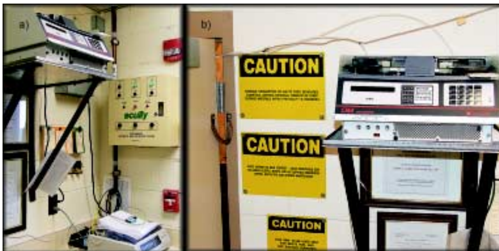
Fot. 3. Wyposażenie pomieszczenia technicznego: a) centralka typu ST-15-LAB instalacji sygnalizacji wycieku hydrazy, b) centralka typu CM4 systemu monitorowania zawartości hydrazy w powietrzu
