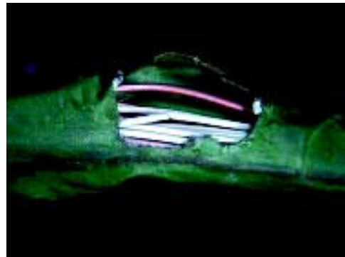
Wiązka elektryczna uszkodzona przez szczury
