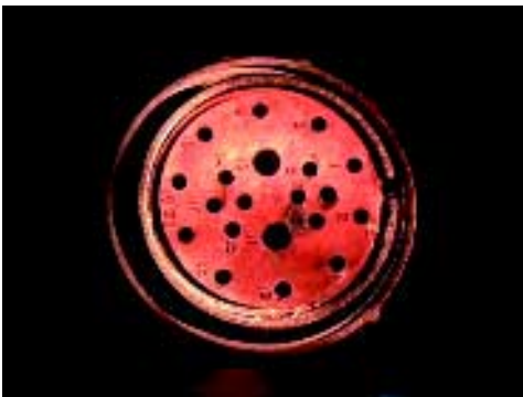
Rozłączone złącze elektryczne z widocznymi śladami przebiegów
