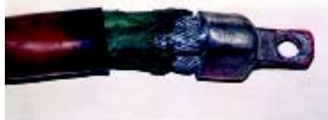
Uszkodzony przewód elektryczny z końcówką do prądnicy GS-18 z samolotu An-26
